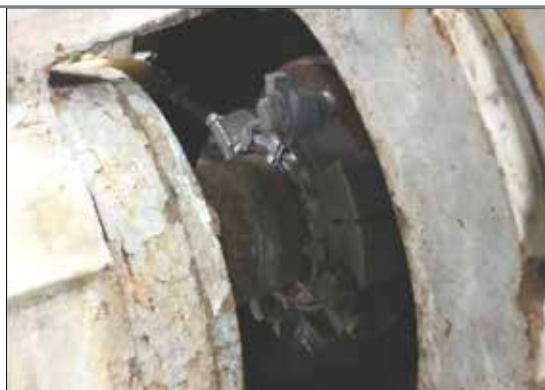
La garniture à cartouche en deux parties 442C de 114 mm (4,50") a été installée en moins de deux heures.
